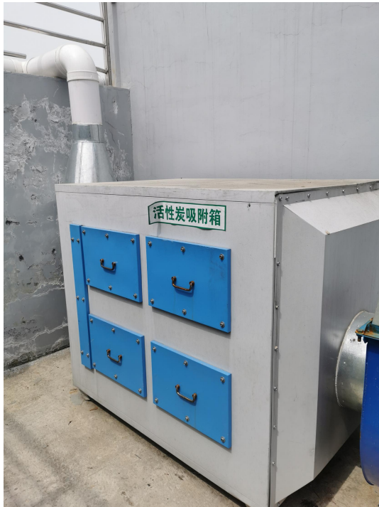
污水处理站活性炭吸附箱
